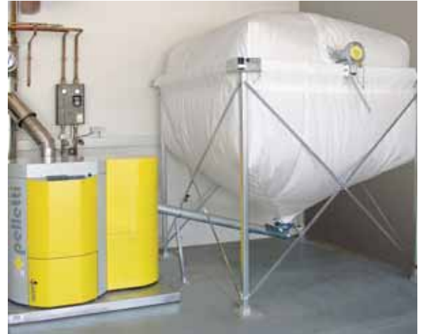
Beispiel für ein Pelletlager mit Sacksilos und Austragung Foto: Paradigma, Karlsbad
